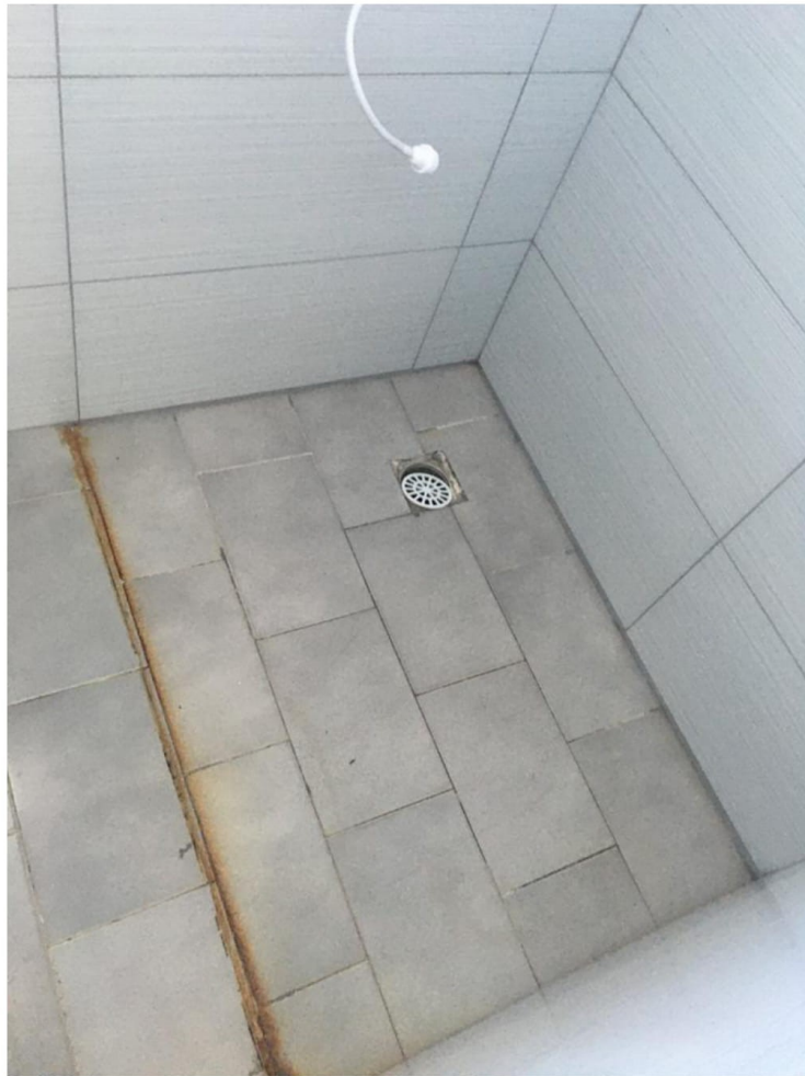
Figura 27: Ralo mal rejuntado. (Fonte: Dos Autores 2020).
