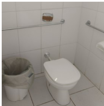
Válvula de descarga do banheiro masculino quebrada.
