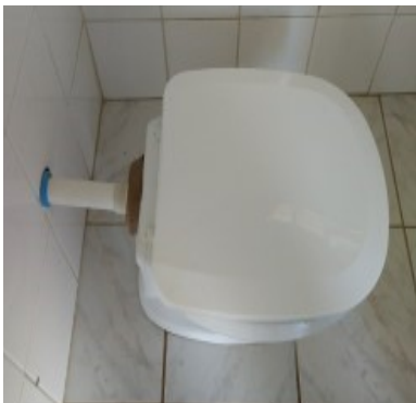
Reparo feito com fita, devido à má instalação.
