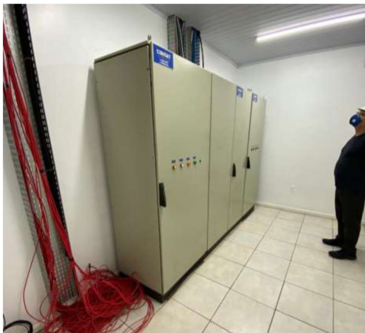
Figura 28: Distribuidor de energia. (Fonte: Dos Autores 2020).
