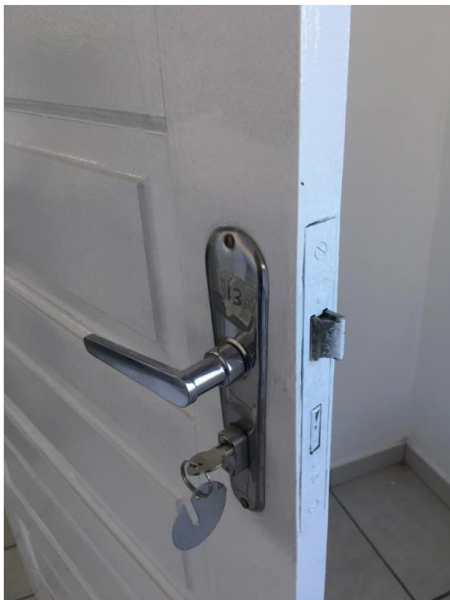
Figura 6: Maçaneta nova. (Fonte: Dos Autores 2020).
