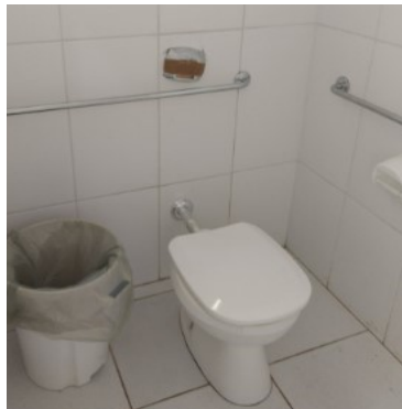
Válvula de descarga do banheiro masculino quebrada.
