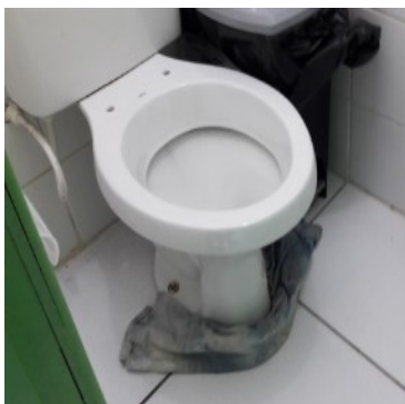
Banheiro com vazamento de água.
