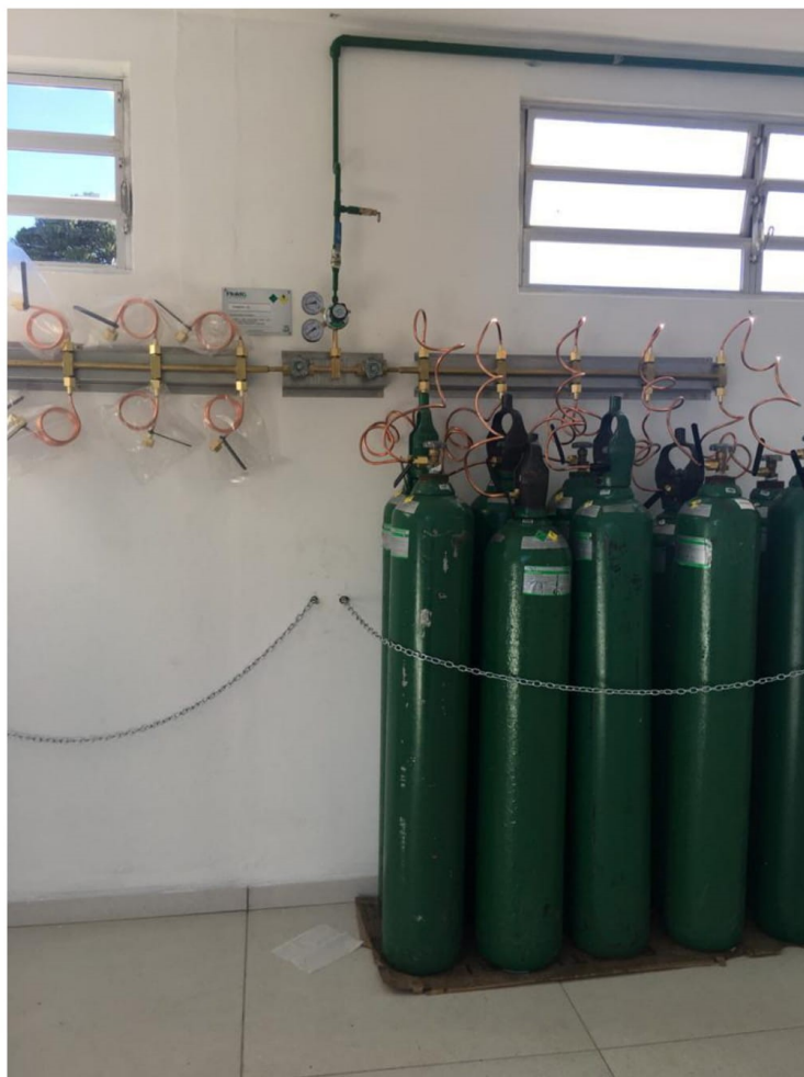
Figura 37: Cilindros de oxigênio instalados. (Fonte: Dos Autores 2020).
