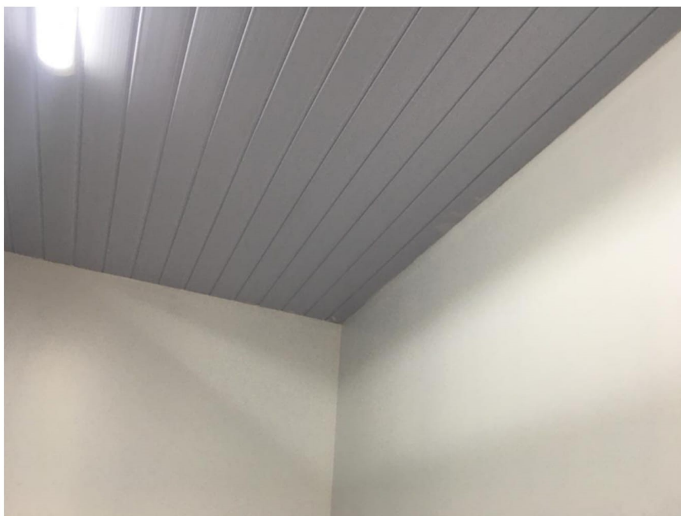
Figura 17: Forro sem acabamento. (Fonte: Dos Autores 2020).
