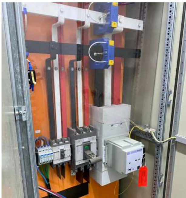
Figura 30: Distribuidor de energia. (Fonte: Dos Autores 2020).
