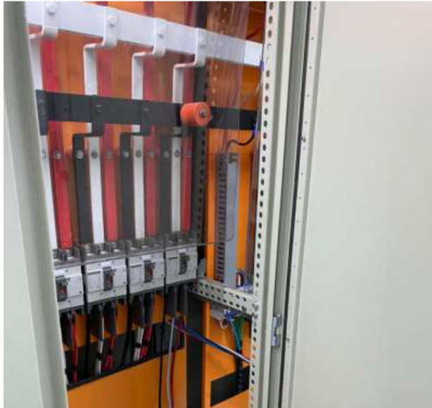
Figura 29: Distribuidor de energia. (Fonte: Dos Autores 2020).
