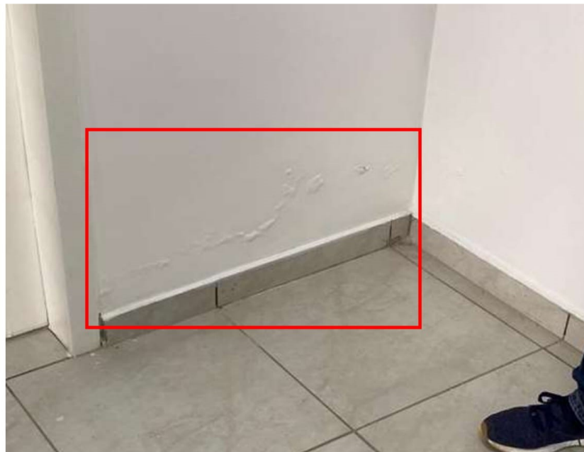
Figura 16: Infiltração a ser reparada. (Fonte: Dos Autores 2020).
