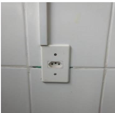
Falta de tubulação na fiação elétrica.
