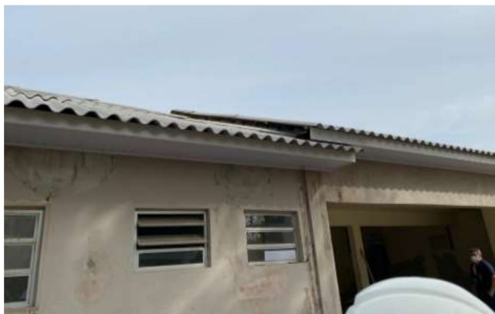
Figura 27: Diferença de nível no telhado a ser coberta. (Fonte: Dos Autores 2020).
