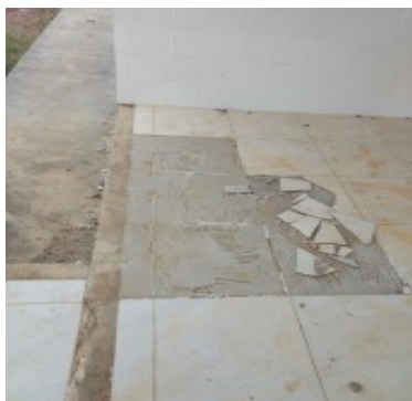
Pisos da área de lazer e banheiro quebrados.
