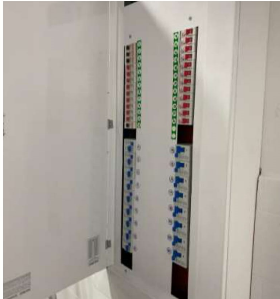
Figura 19: Central de disjuntores. (Fonte: Dos Autores 2020).
