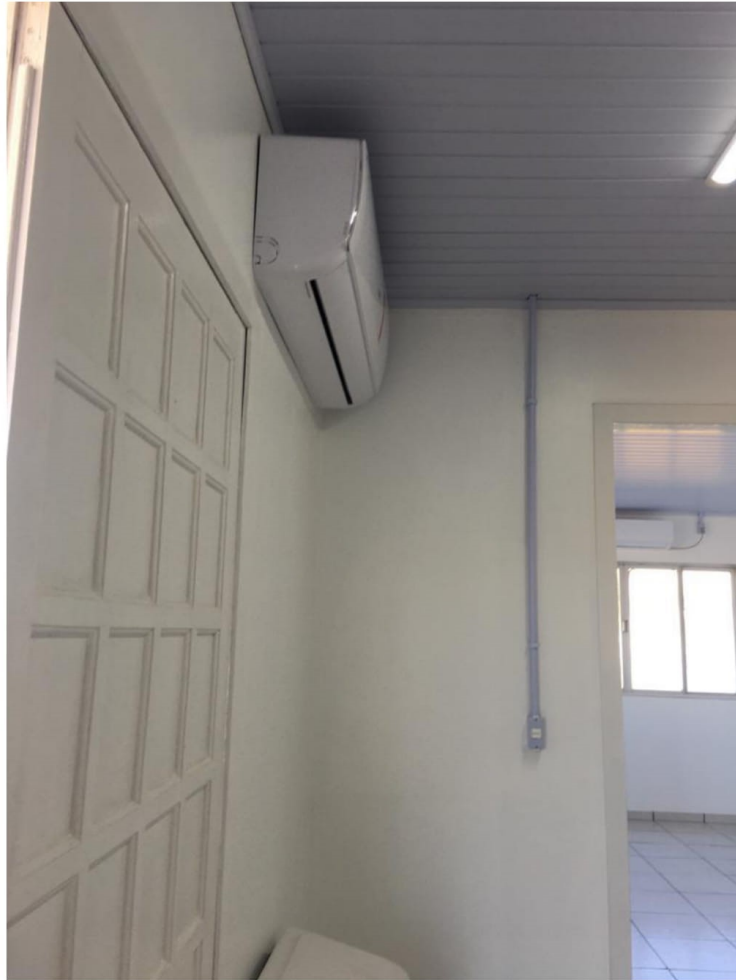
Figura 13: Ar condicionado da recepção. (Fonte: Dos Autores 2020).
