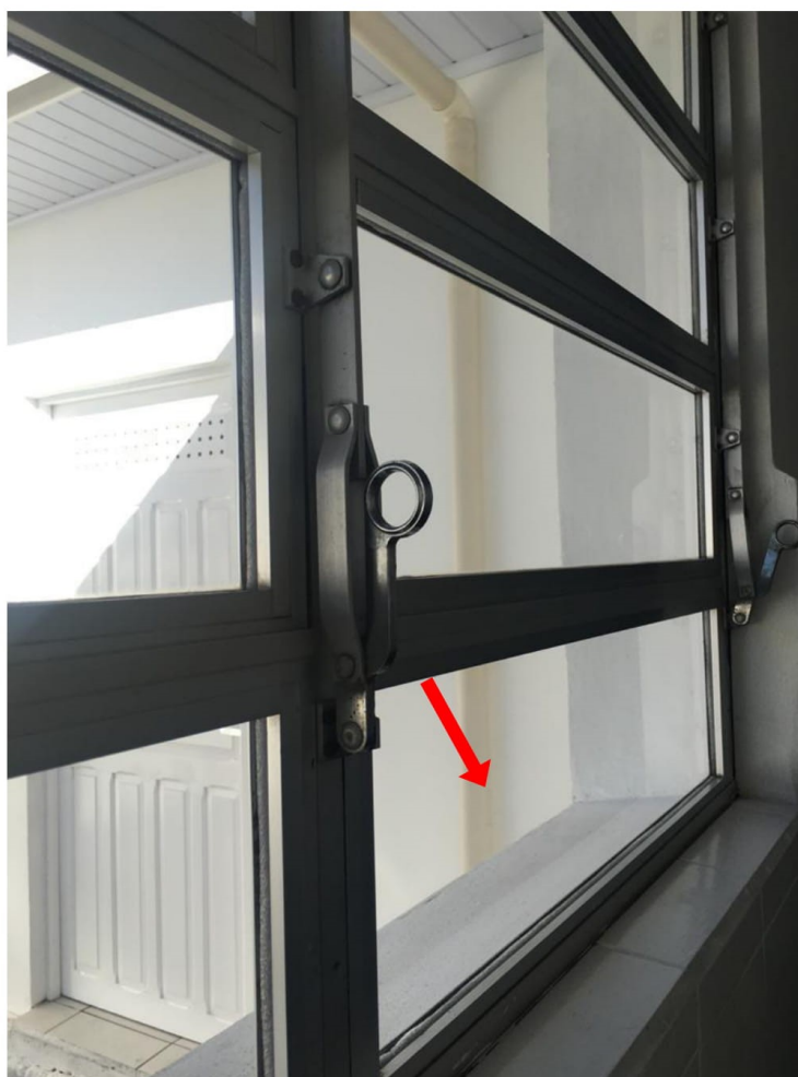
Figura 21: Janela sem pedra pingadeira. (Fonte: Dos Autores 2020).
