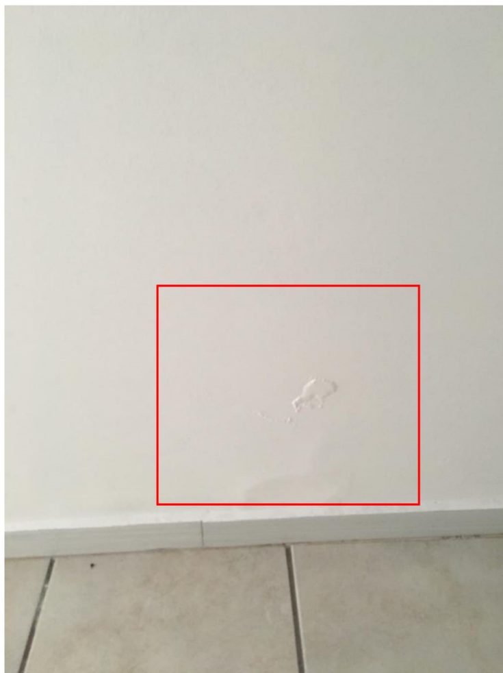
Figura 11: Infiltração na parede. (Fonte: Dos Autores 2020).
