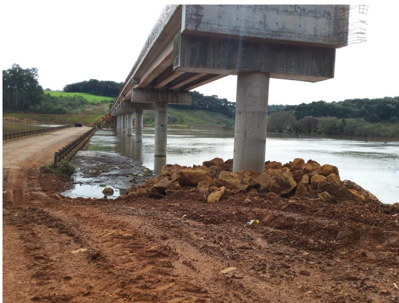
Figura 16 - P5 após alagamento consequente da barragem São Roque (13/08/2022).
