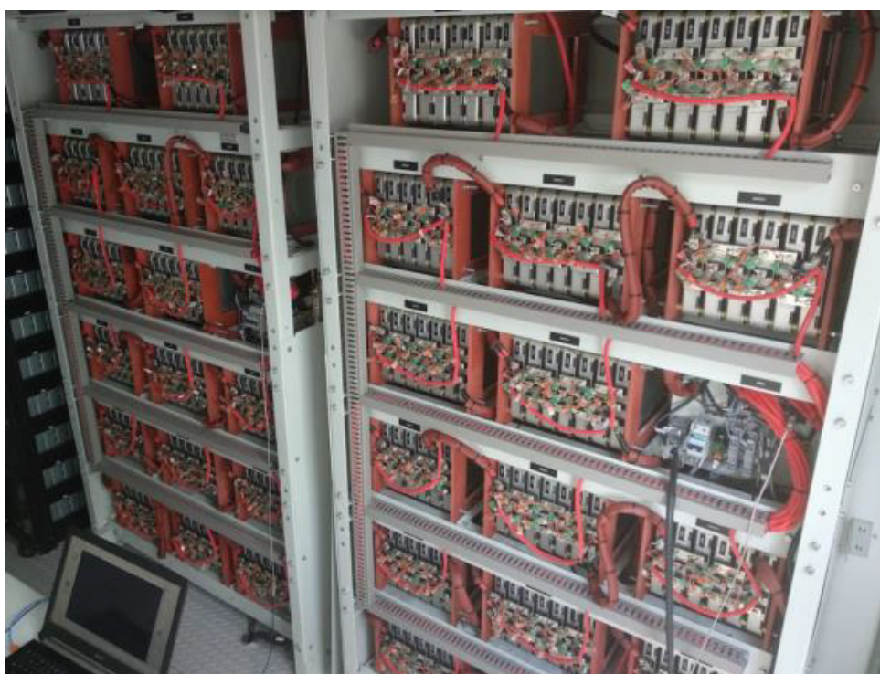
Figura 32 – Racks de baterias em segunda vida.
