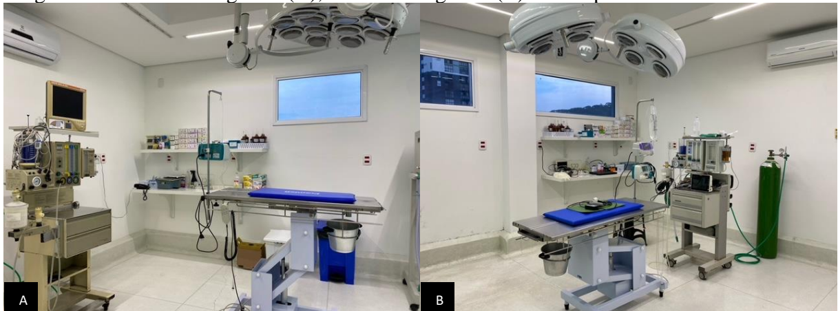
Figura 35 - Centro cirúrgico 1 (A), Centro cirúrgico 2 (B) do Hospital Veterinário Vet Plus.
