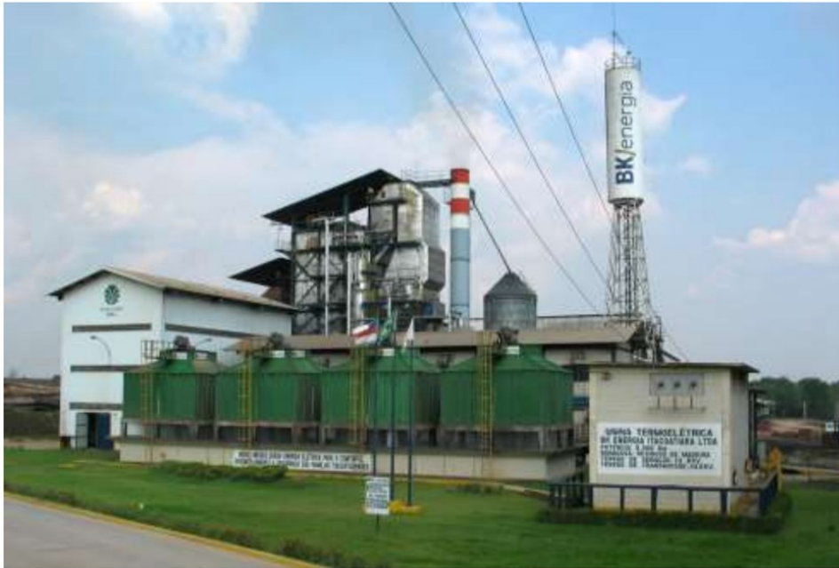
Figura 10 – Usina termelétrica BK Energia Itacoatiara
