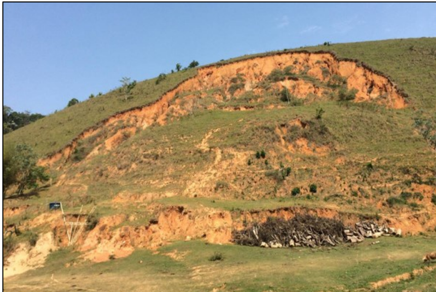
Figura 10 – Deslizamento rotacional em talude de Rio Claro – RJ.
