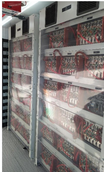
Figura 2.13 – Baterias de segunda vida compondo um BESS implementado no Laboratório Fotovoltaica da UFSC.
