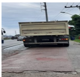
Situação de Risco
