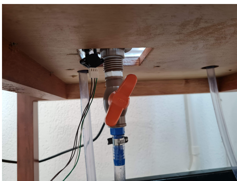
Figura 13 – Válvula tanque retangular.
