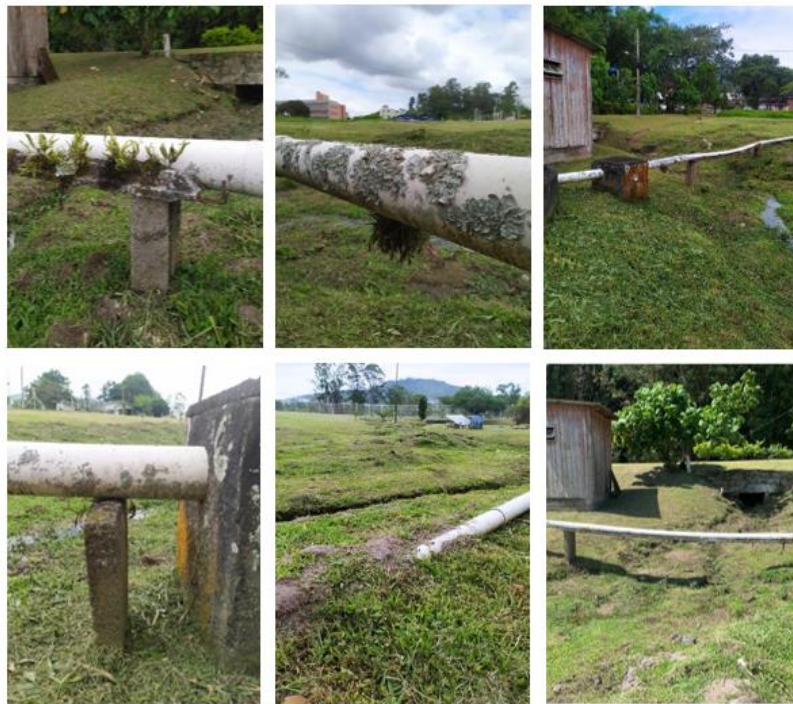
Figura 6 – Tubulação de entrada do tratamento de efluente
