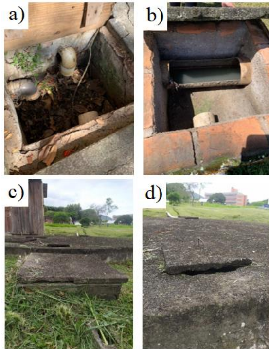
Figura 7 – Componentes do sistema de tratamento em más condições
