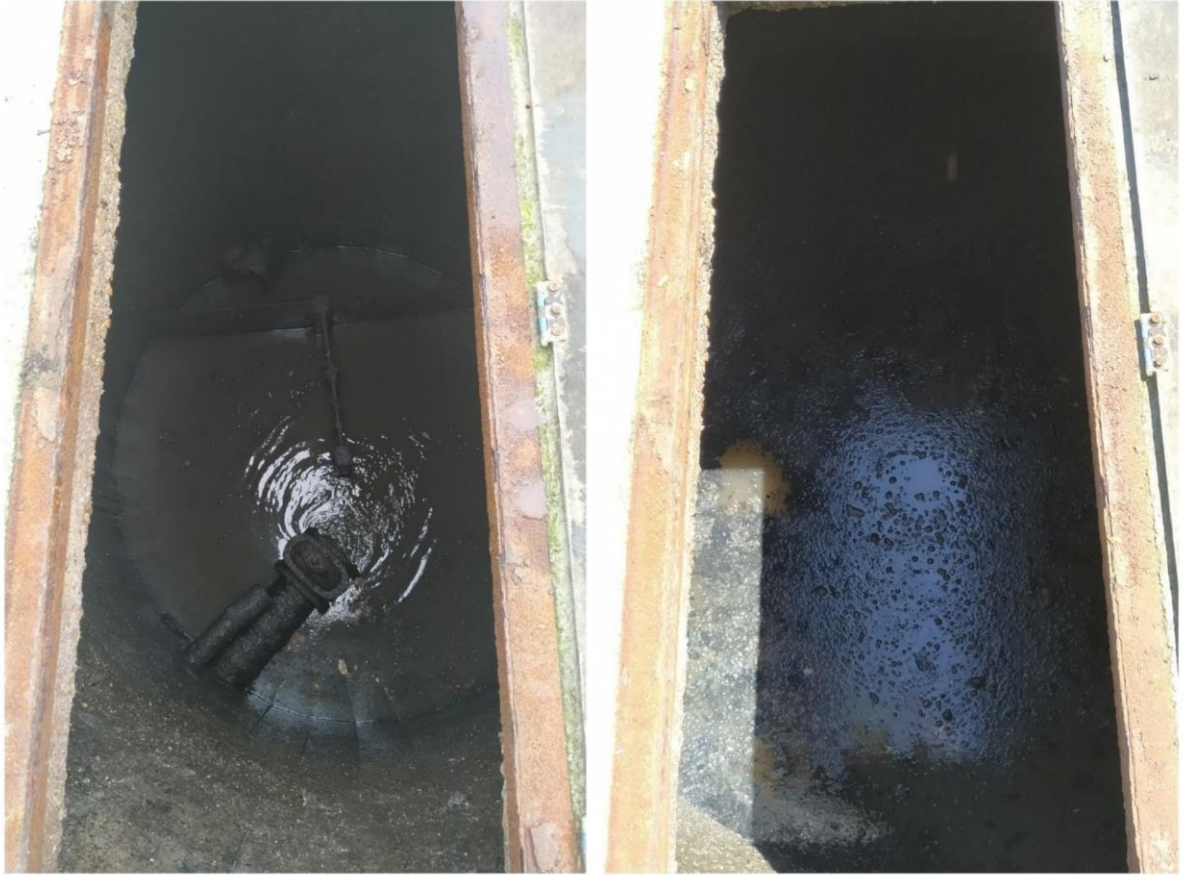
Figura 16 – Comparação do nível da caixa de gordura durante a operação diária.
