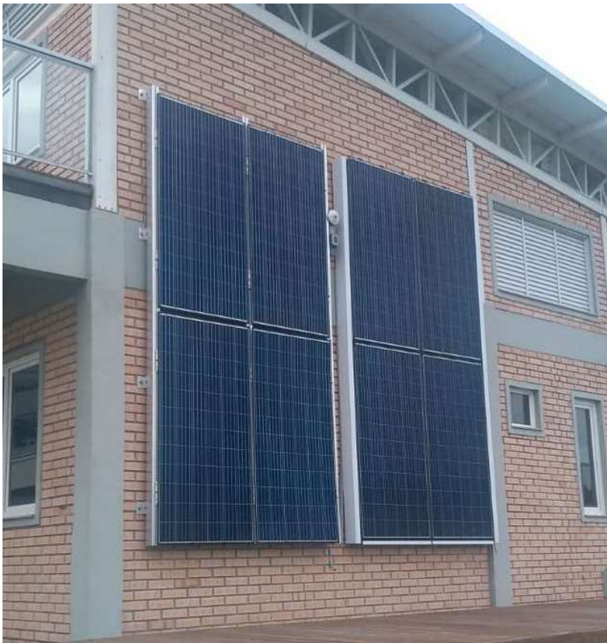
Figura 25 – Sistema de fachada ventilada (à esquerda) e estanque (à direita) de módulos fotovoltaicos instalada no Fotovoltaica – UFSC em Florianópolis, Brasil
