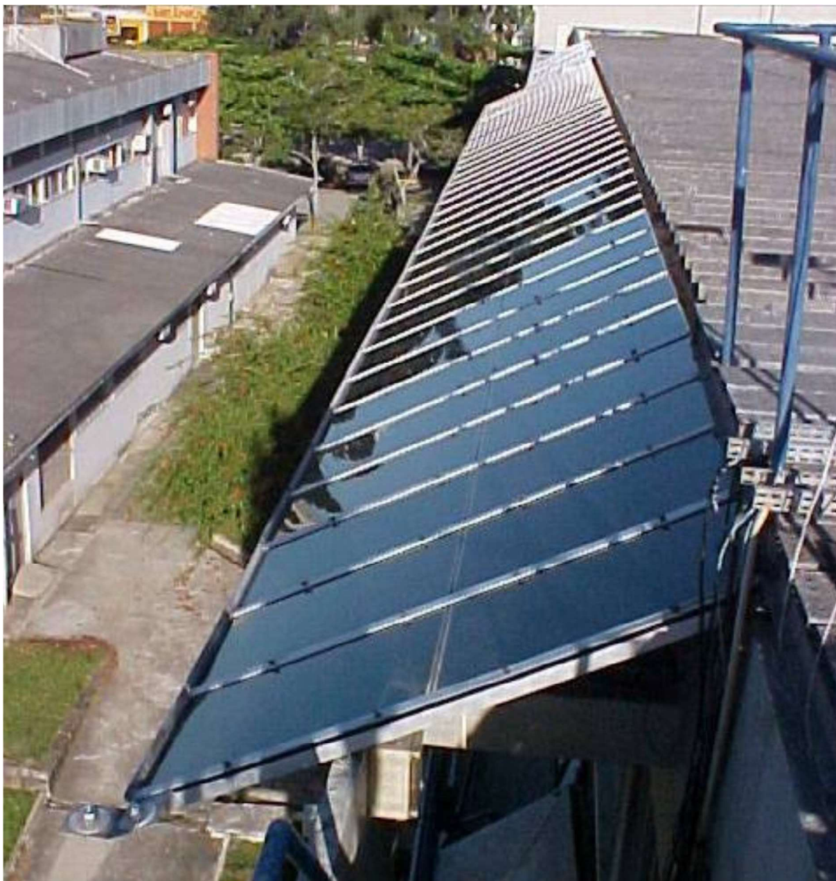
Figura 9 – Primeiro Sistema fotovoltaico conectado à rede e integrado a uma edificação do Brasil, sistema de 2kWp.
