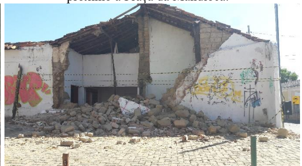
Figura 10: Edificação que ruiu em maio de 2020, próximo à Praça da Mandioca.
