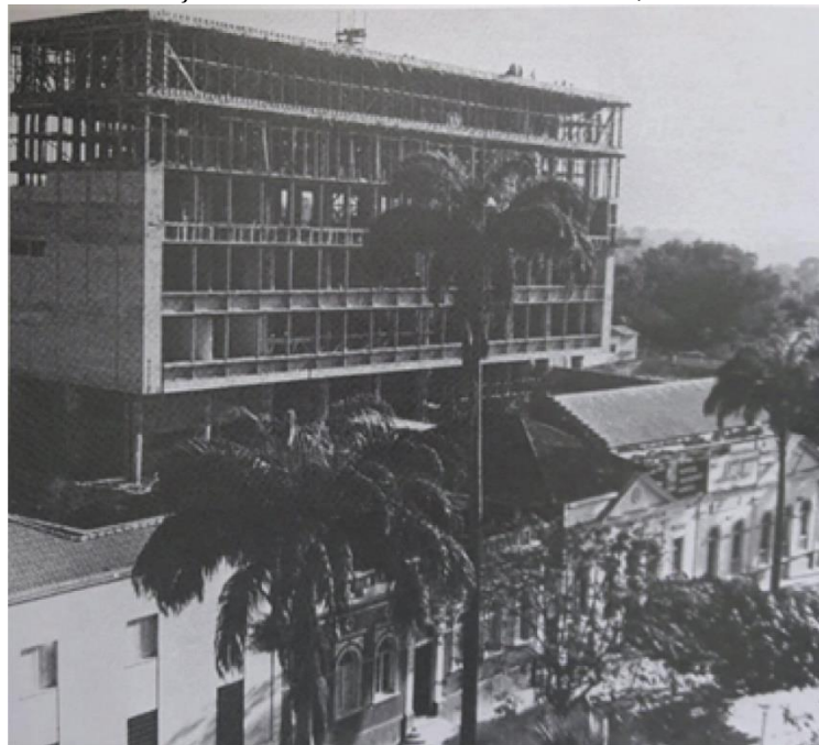
Construção do novo Palácio, com influências modernas, aos fundos do Palácio Alencastro e da Delegacia Fiscal. Fonte: Siqueira et al. (2006)
