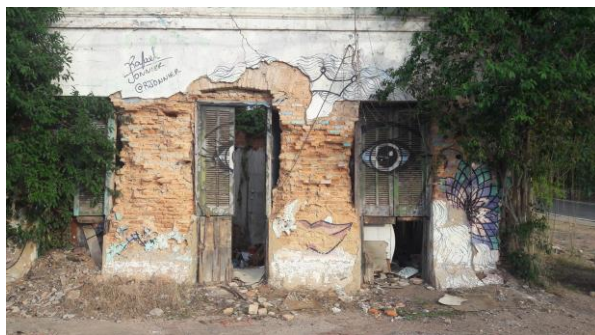
Figura 9: Ruína no Centro, na Ilha da Banana
