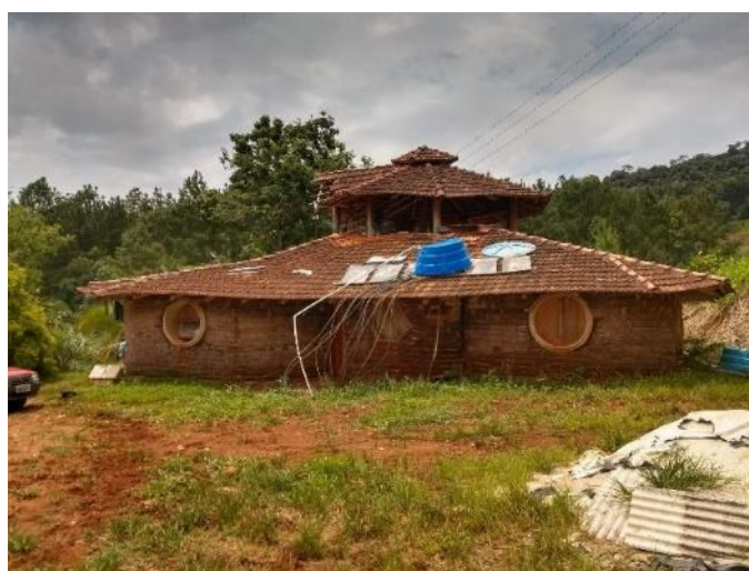
Figura 76: Vista da fachada norte com o sistema de placas solares inativo (foto de 2020).
