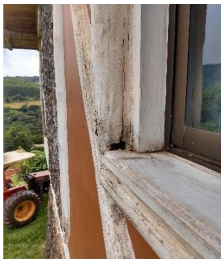
Figura 132: Diversos elementos estruturais feitos de madeira de eucalipto apresentam apodrecimento, especialmente nas fachadas mais expostas (foto de 2020 mostrando detalhe da fachada leste)
