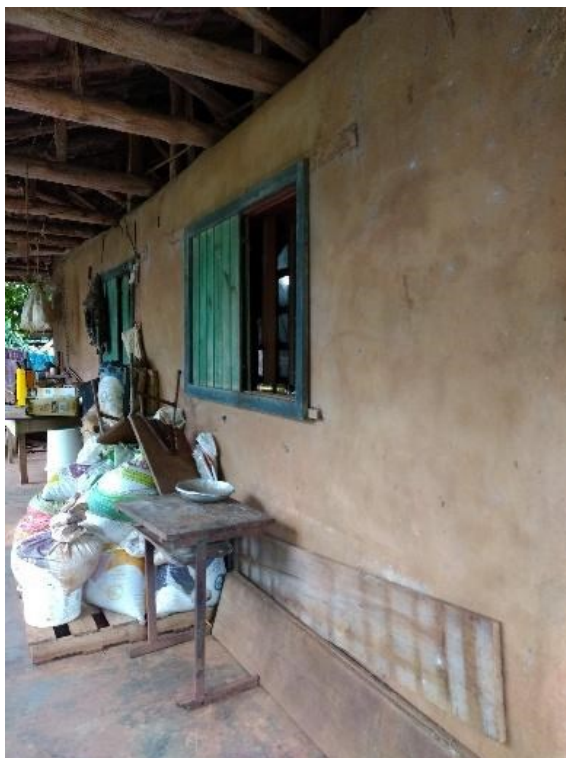
Figura 66: Ausência de forro na varanda torna a cobertura vulnerável a vendavais.
