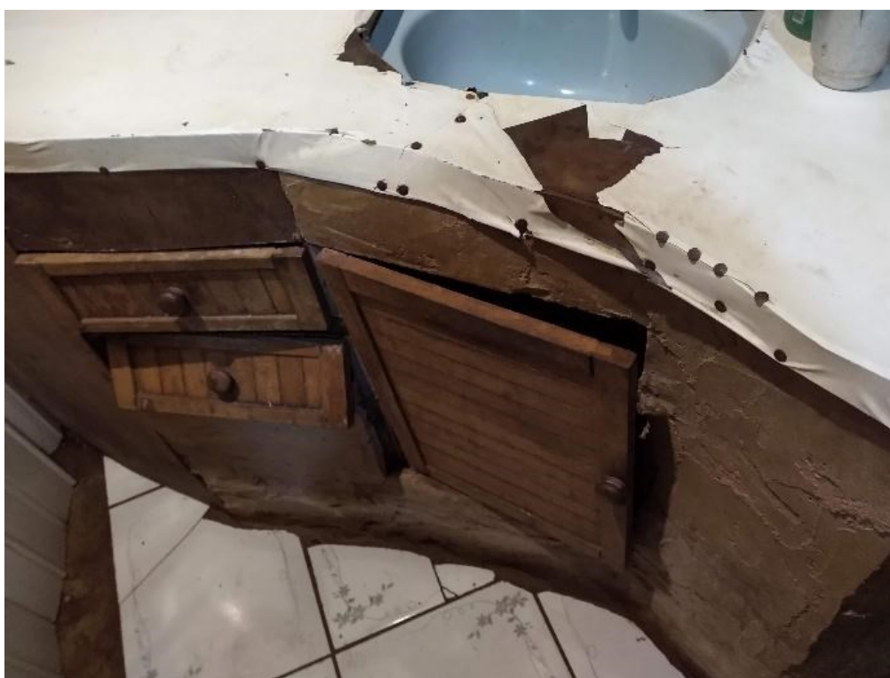
Figura 87: Mobiliário do banheiro, feito artesanalmente em ferrocimento, encontra-se em estado precário. Superfície da pia forrada com lona plástica. Foto de 2020.
