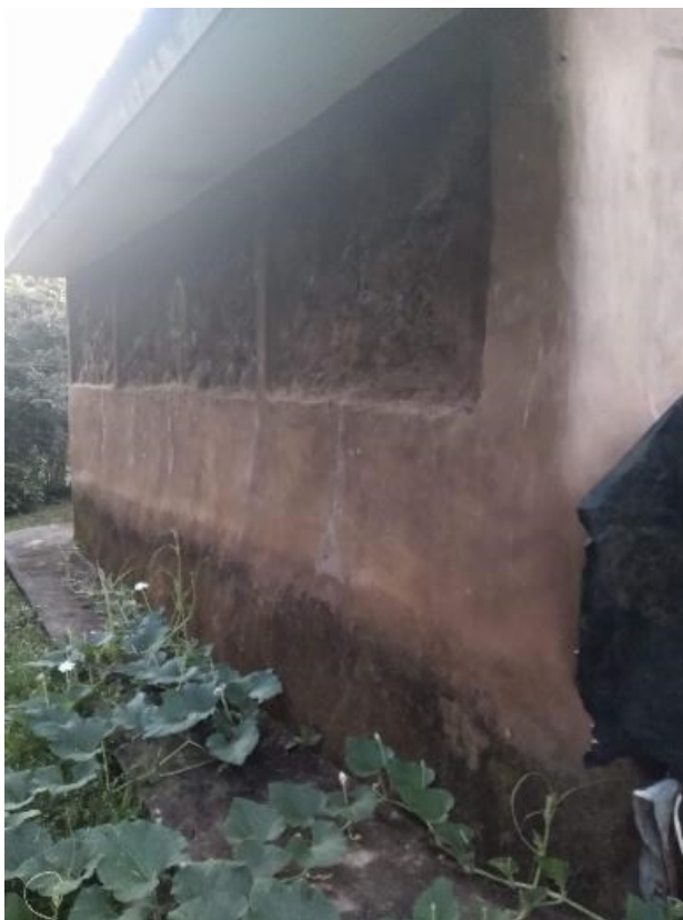
Figura 47: Ausência de forro na varanda torna a cobertura vulnerável a vendavais.
