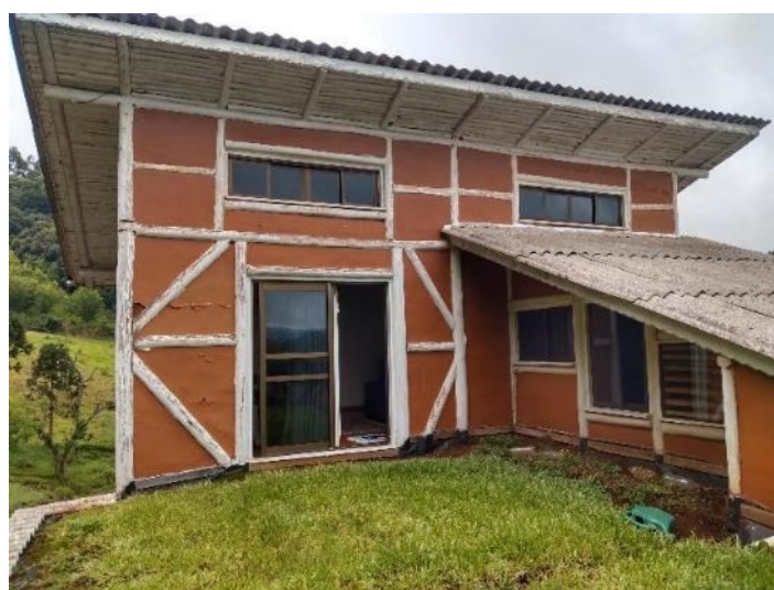
Figura 143: Lado esquerdo da fachada oeste apresenta despedramento da pintura e apodrecimento de elementos de madeira (foto de 2020)
