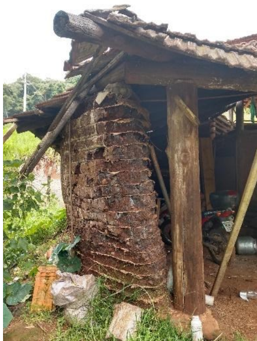
Figura 92: Degradação do madeiramento da cobertura expõe as paredes de terra às intempéries. Percebe-se também a parede fora de prumo com risco de colapso (2020)
