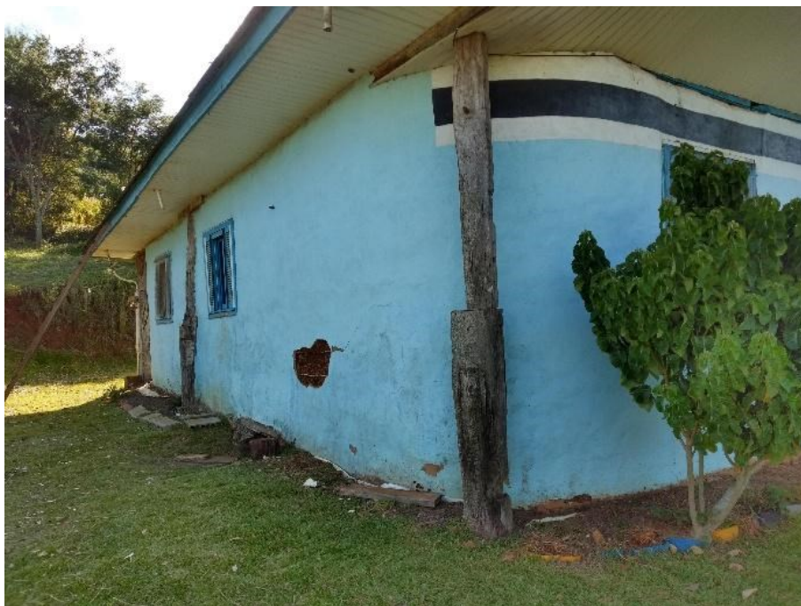
Figura 126: Percebe-se a erosão do reboco externo em alguns pontos na base da parede (foto de 2020)
