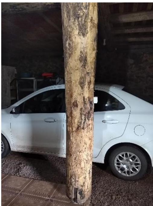
Figura 134: No porão as paredes externas são estruturais e internamente a estrutura é de madeira (foto de 2020)
