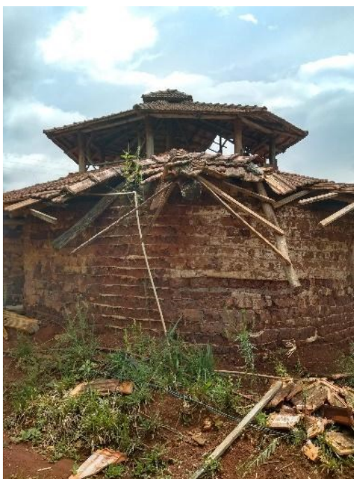
Figura 83: Estado da cobertura no lado sul da edificação demonstra falta de integridade estrutural, tornando a edificação suscetível a vendavais.
