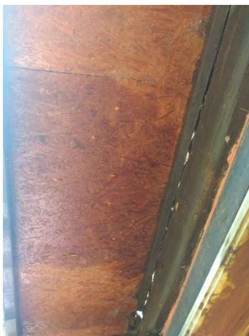
Figura 110: Presença de umidade proveniente da ação da chuva no forro do beiral (foto de 2020)
