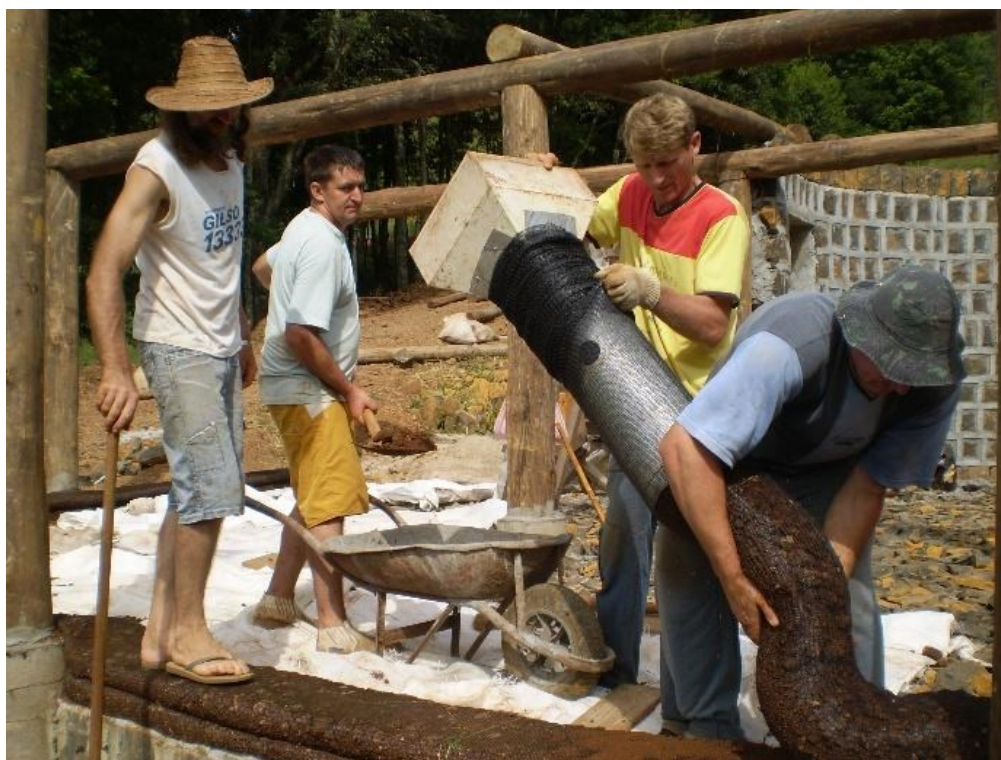
Figura 104: Parentes e amigos auxiliando na execução da terra ensacada (foto de 2009). O funil longo e com bocal largo foi desenvolvido pela família.
