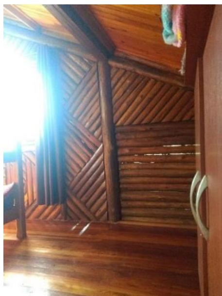
Figura 100: Parede de madeira roliça apresenta frestas que geram perdas térmicas (foto de 2020)
