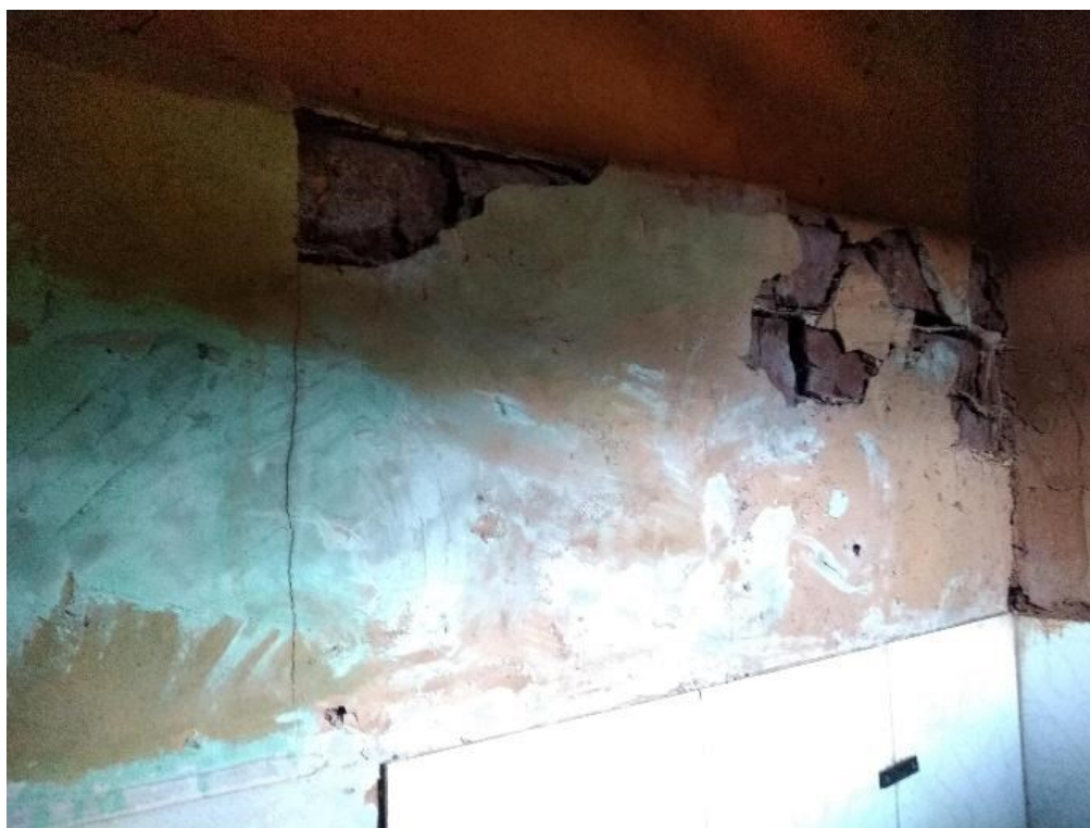
Figura 70: Parede interna do banheiro com reboco danificado comprometendo o bem estar dos usuários.
