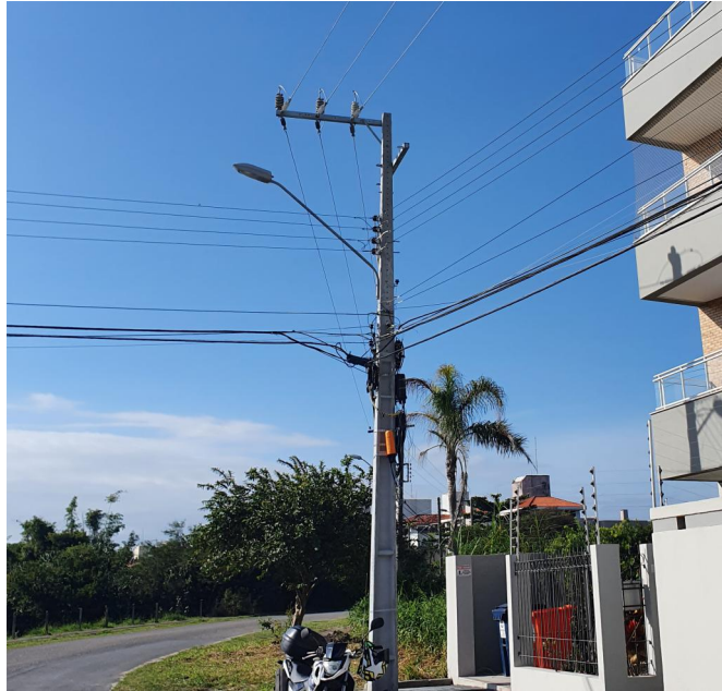
Figura 9 – Redes em poste.
