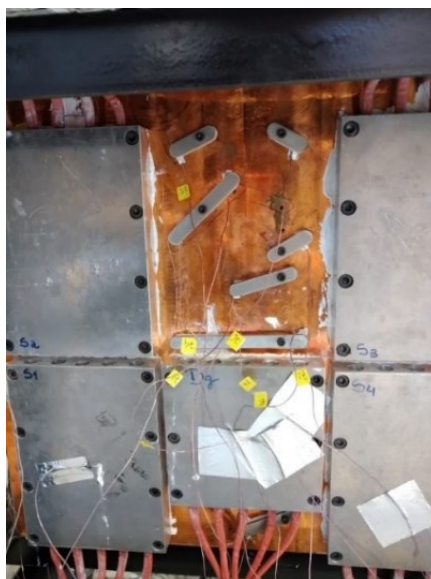
Figura 58: Fixação dos termopares na face do evaporador.
