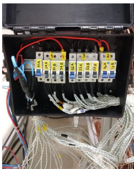
Figura 54: Quadro de disjuntores para as resistências elétricas nos blocos aquecedores.
