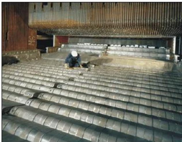
Figura 4 - Grelha Horizontal, onde ocorre a incineração dos RSU na usina termelétrica.
