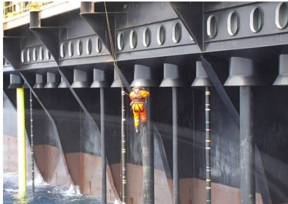
Figura 1 - Exemplo de inspeção externa em bancada de risers no costado de uma plataforma do tipo FPSO com a técnica de escalada industrial.
