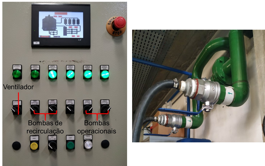
Figura 4.16 – Procedimento de início de funcionamento do ramal frio da bancada experimental.
