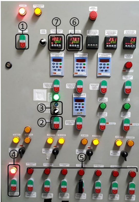
Figura 4.17 – Quadro de comando para o ramal quente.
