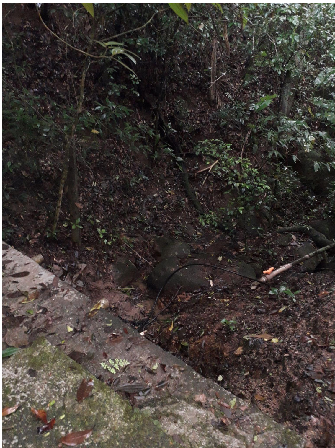
FIGURA 8: Hotel SESC Cacupé Mini Barragem 2 ( FOTO Renan da Costa) Saída e tubulações do ponto de captação de água dos moradores do entorno do Hotel.
