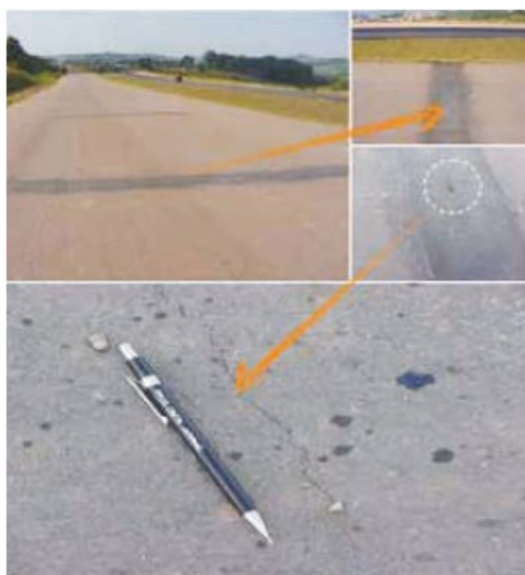
Figura 31 - Reaparecimento das trincas de reflexão.
