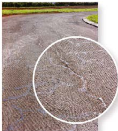
Figura 37 - Trinca no pavimento original após fresagem.
