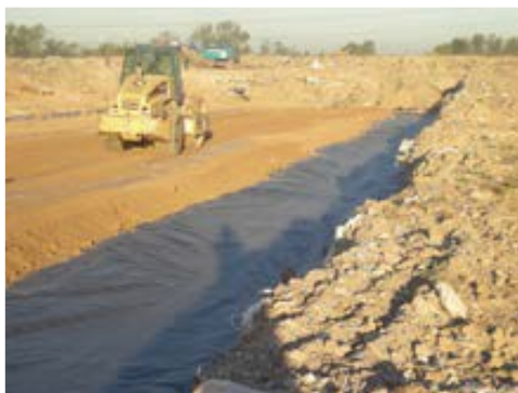
Figura 35 - Compactação da camada de solo selecionado sobre o geotêxtil de reforço e separação.
