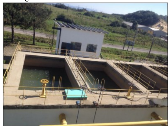
Figura 15 - ERAT e filtros da ETA.
