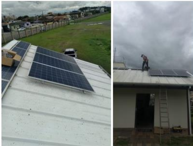
Figura 4 – Instalações do sistema fotovoltaico em análise.
