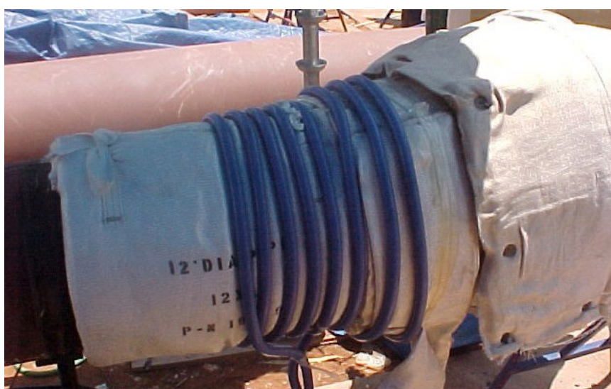
Figura 73 - Exemplo de bobina montada em campo
