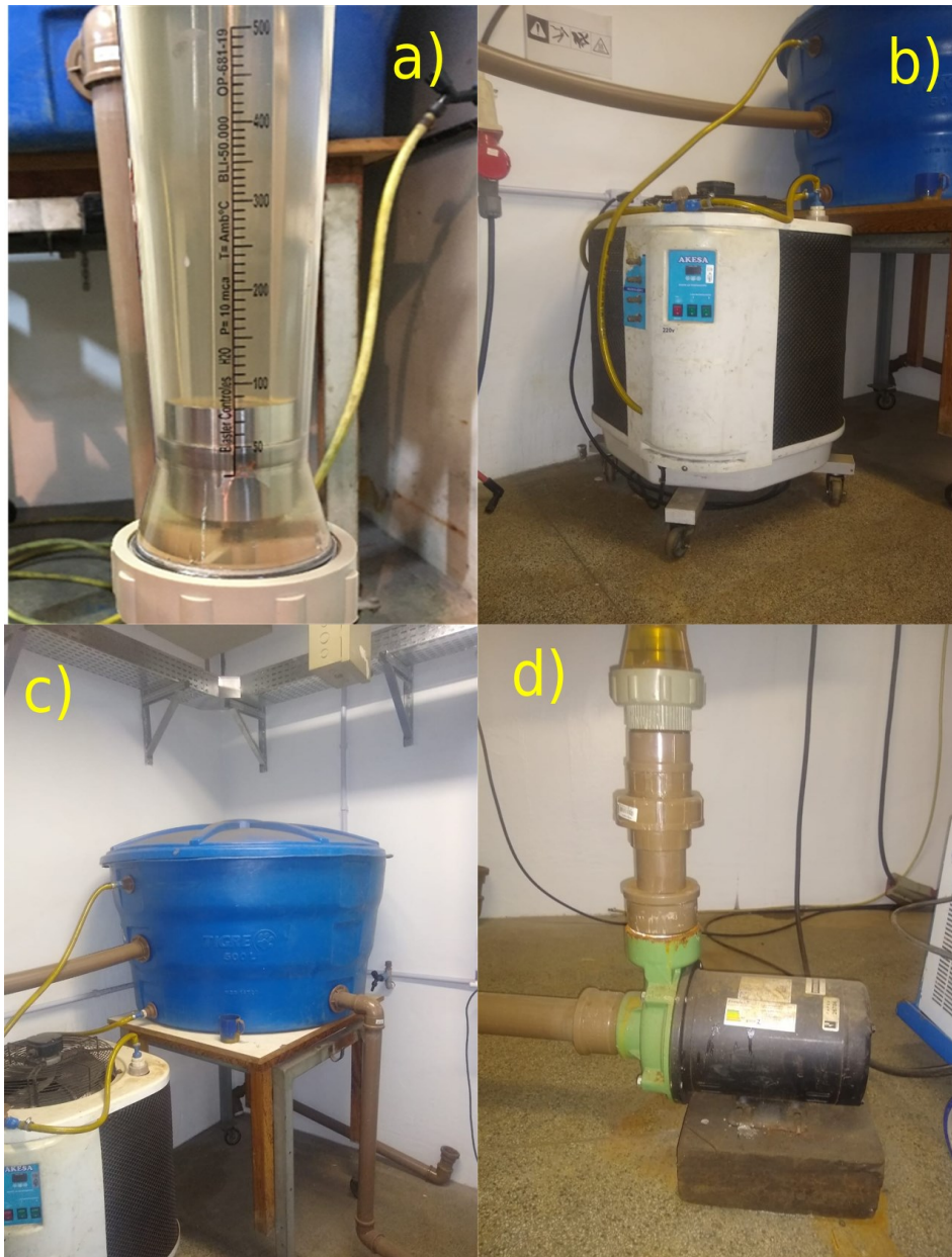
Figura 26 - Componentes do circuito hidráulico com exceção do tubo. a) Rotâmetro b)Chiller c) Reservatório d) Bomba de 1 cv.
