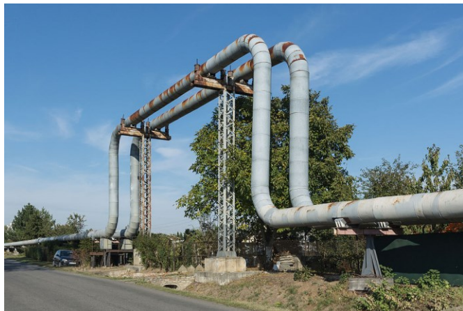
Figura 7 - Laço de expansão térmica em tubulação de óleo. Fonte: www.wikiwand.com/en/Thermal_expansion . Acesso em 10/12/2020.
