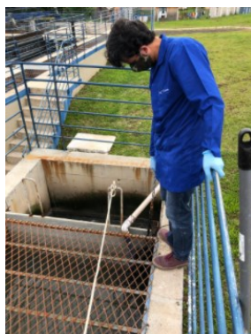
Figura 14 – Poço de recalque do esgoto bruto após passar pelo gradeamento
