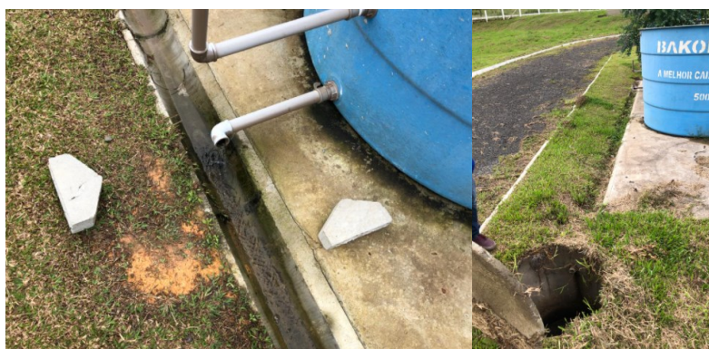
Figura 16 – Calha de coleta e poço de armazenamento do esgoto tratado
