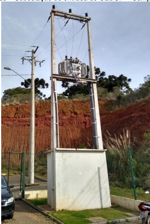
Figura 20 – Subestação de entrada do CEDUP – Campus CBS.
