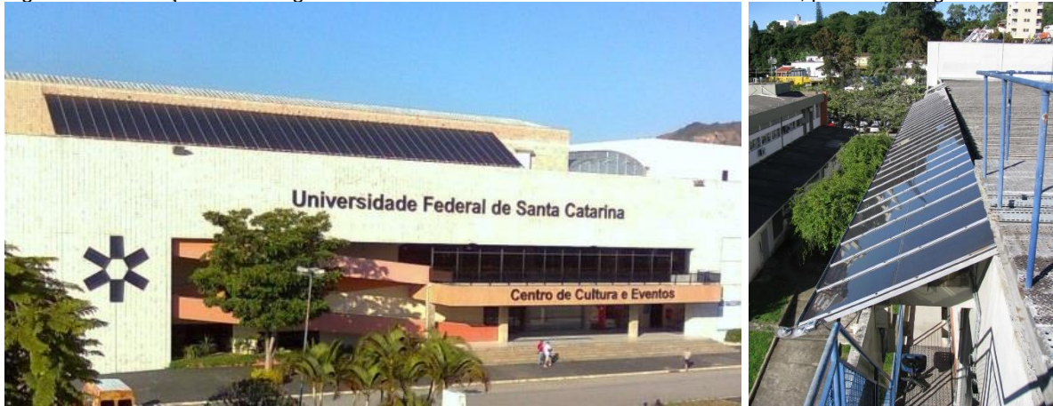
Figura 3 – Instalações de energia Fotovoltaica UFSC – Centro de Cultura e Eventos, prédio da Eng. Mecânica.
