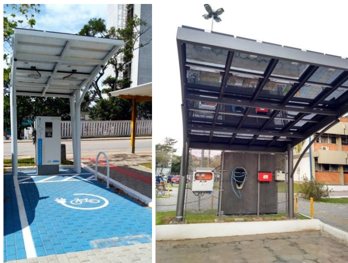
Figura 5 – Instalações de energia Fotovoltaica UFSC – Eletroposto (CERTI e CTC).
