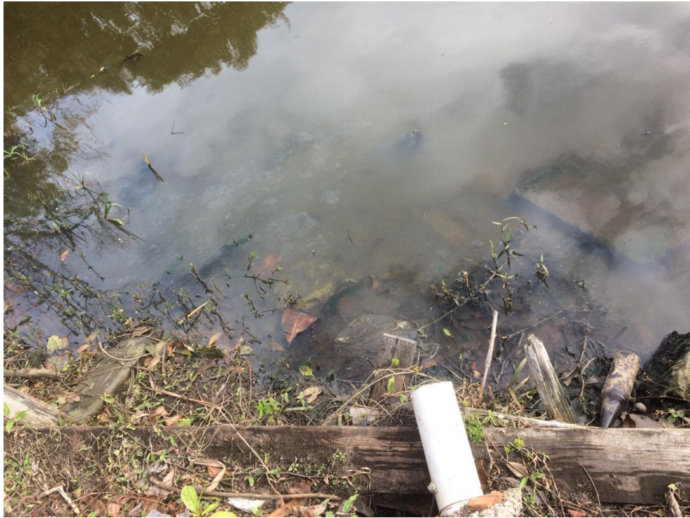
Figura 2 - Lançamento de esgoto de forma irregular no Canal Sangradouro.
