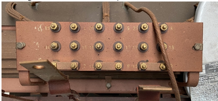
Figura 23 – Painel de comutação de um transformador.
