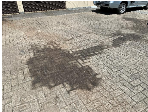
Figura 44 – Manchas de óleo no pavimento da área externa
