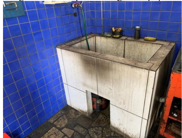
Figura 22 – Tanque de lavagem de peças
