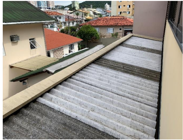
Figura 48 – Vista superior do telhado a ser substituído
