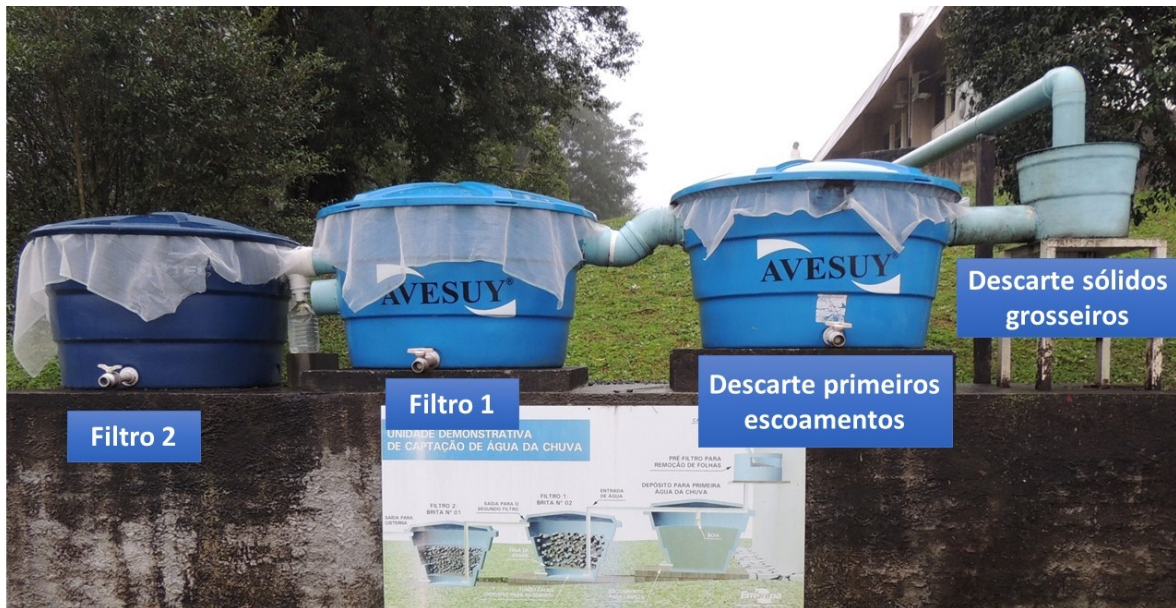
Figura 14. Sistema de aproveitamento de água da chuva da Embrapa Suínos e Aves – Concórdia - SC
