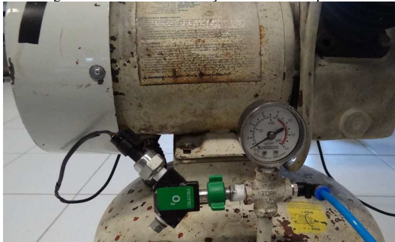
Figura 27 – Ponto de instalação do sensor de pressão
