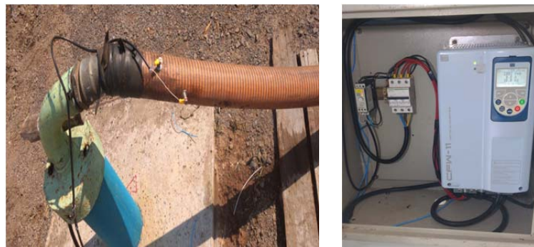
Figura 70. Instalação hidráulico-mecânica e elétrica do poço de produção.
