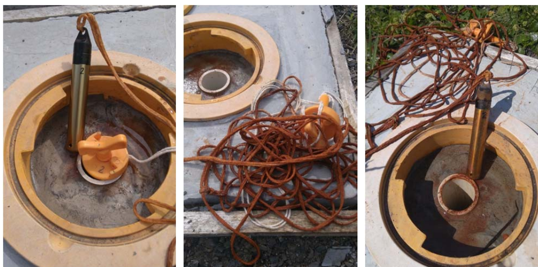
Figura 85 - Encrustamento com ferro oxidado (ferrugem) no medidor de nível do P2
