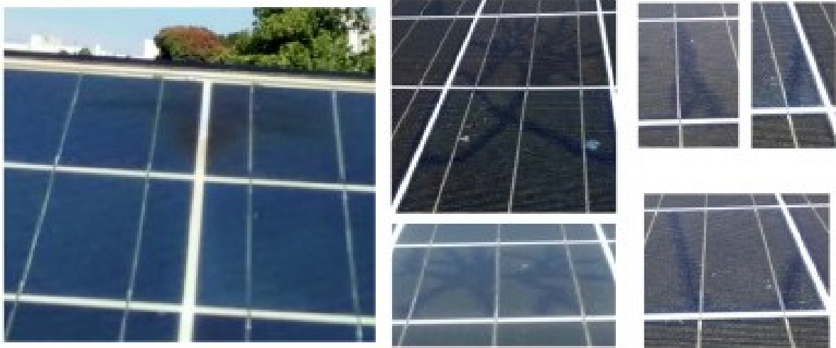
Figura 4 – Exemplos de degradações ocorridas em condições de operação.
