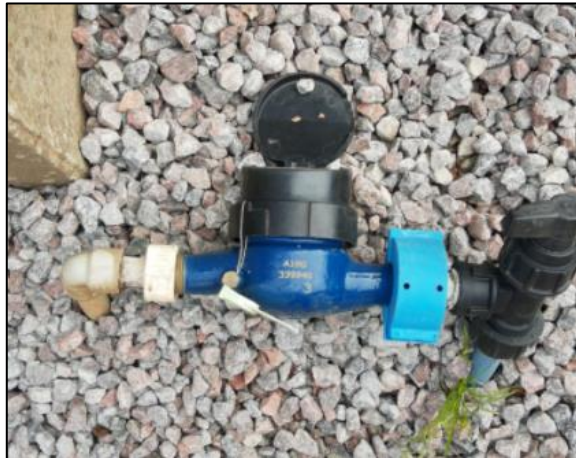
Figura 14 – Exemplo de hidrômetro inclinado em Brusque.
