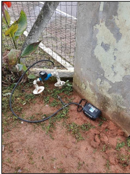
Figura 42 – Datalogger instalado no ponto 3.
