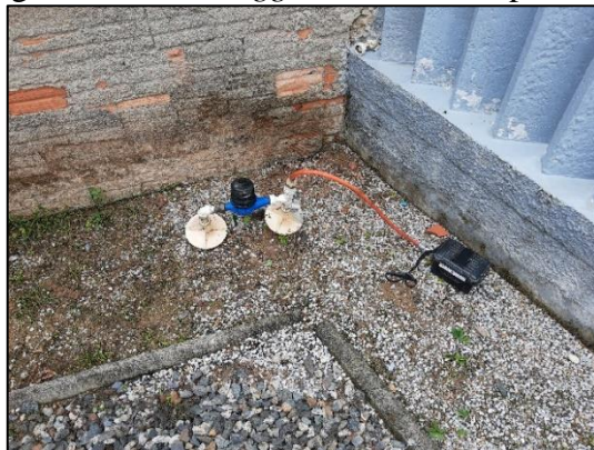
Figura 44 – Datalogger instalado no ponto 5.
