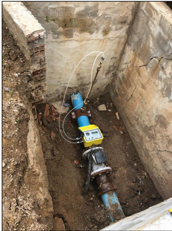
Figura 37 – Procedimento de Pitometria na saída do Reservatório.
