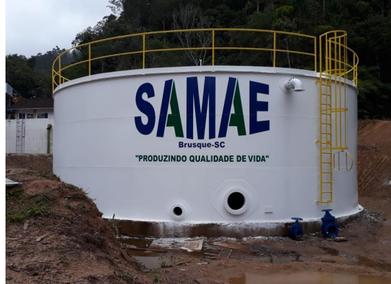
Figura 65 – Novo reservatório, 500 m 3 .
