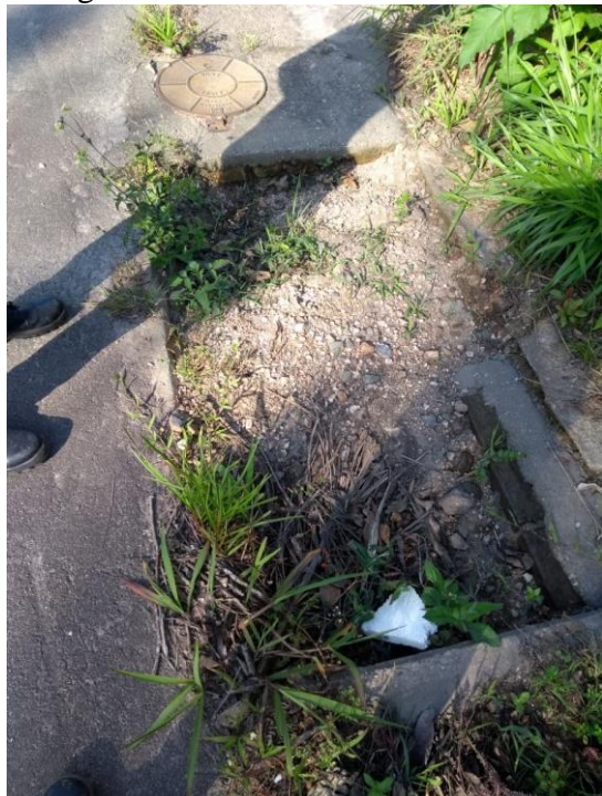
Figura 98 – Local da VRP obstruído.
