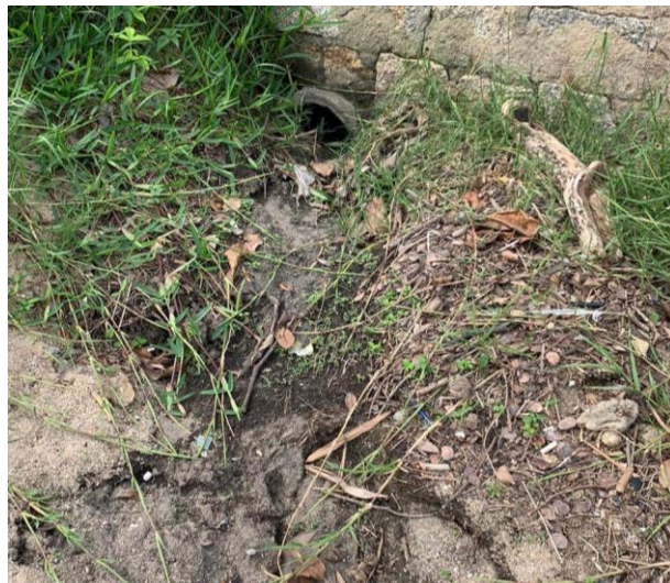
Figura 26 – Tubulação parcialmente obstruída na Praia das Flores
