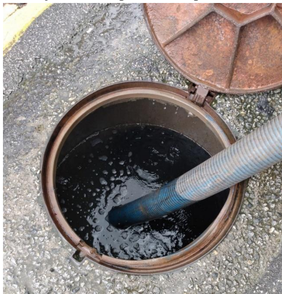
Figura 13 – Poço de visita preenchido por efluente doméstico
