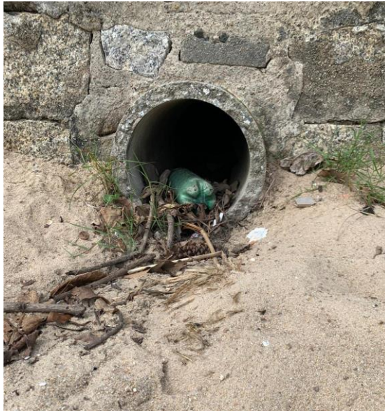
Figura 25 – Tubulação com acúmulo de lixo e plantas secas na Praia das Flores
