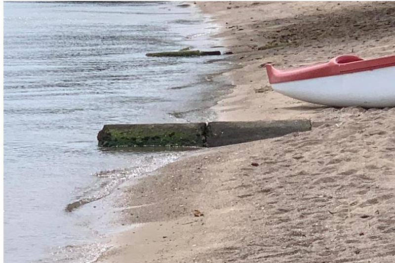
Figura 27 – Tubulação com saída direta no mar na Praia das Flores
