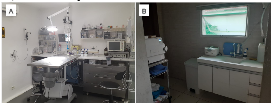
Figura 5 – Wildvet Clínica Veterinária. A: sala de cirurgia 1 e B: sala para limpeza e esterilização de material cirúrgico.
