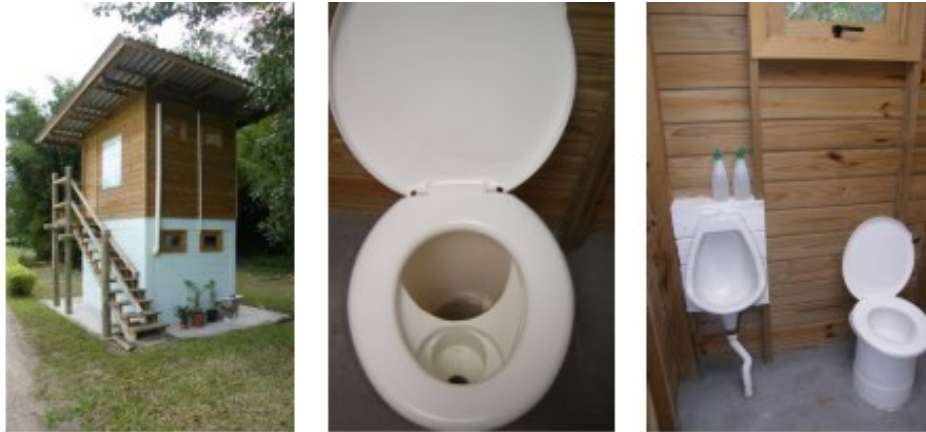
Figura 4. Banheiro seco separador instalado no CETRE.
