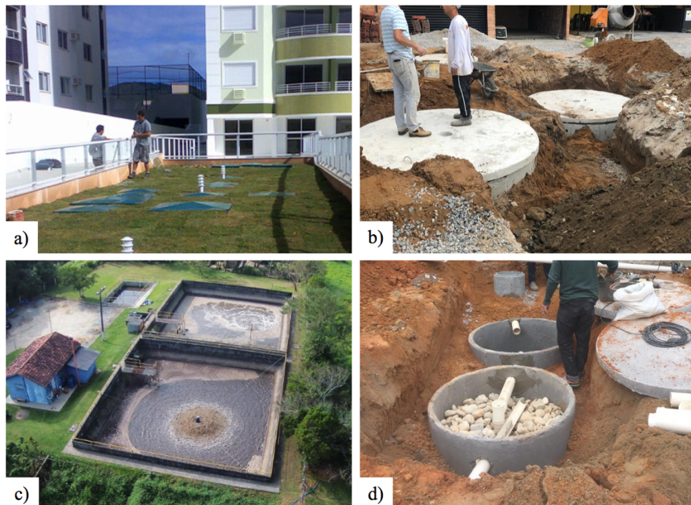
Figura 13 – Fotos ilustrativas de lodo ativado em batelada (a e c) e filtro anaeróbio (b e d) implantados em escala real com modo de construção escavados no solo com alvenaria em concreto.
