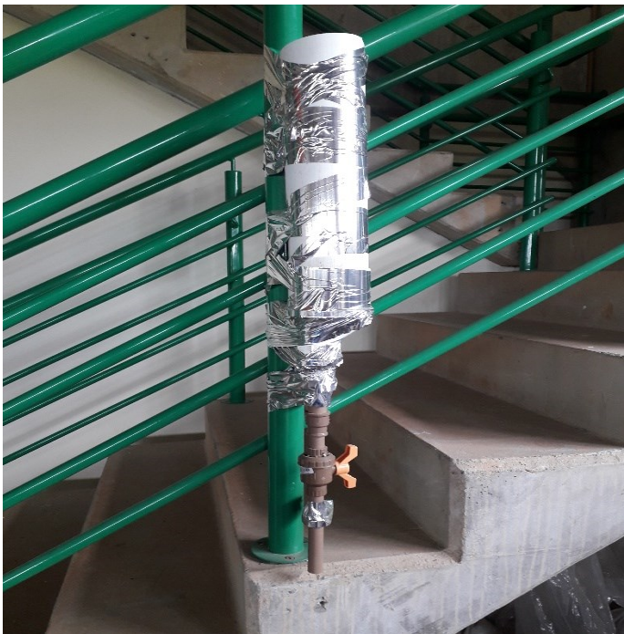
Figura 11 – Dosador contínuo de zeólitas.
