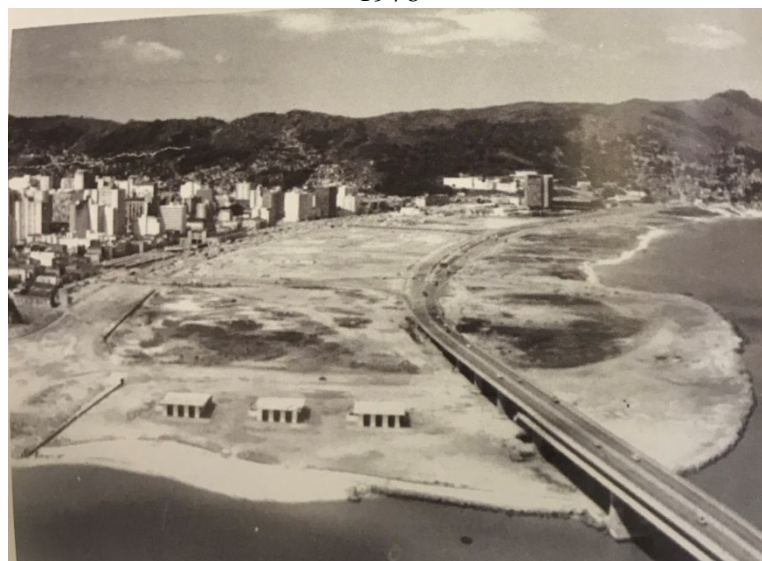
Figura 19 – Vista das novas sedes dos três clubes de remo sendo construídas no aterro em 1978
