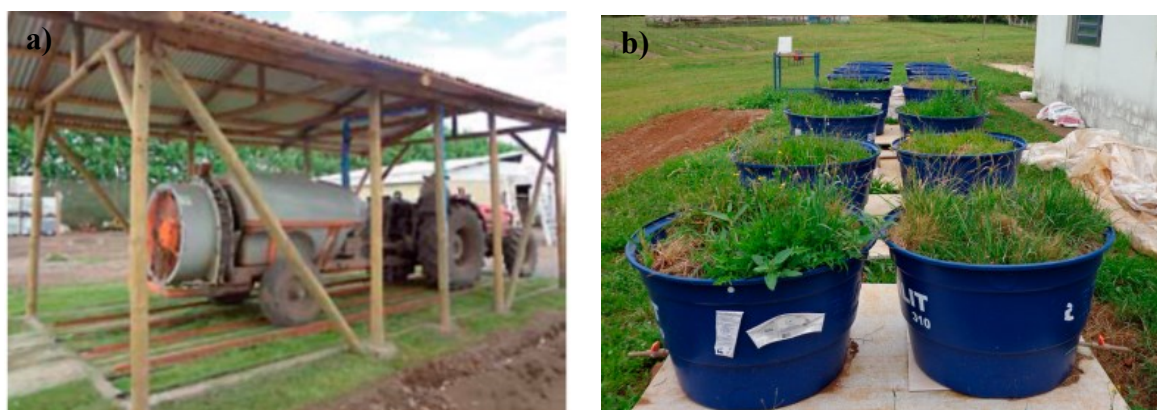
Figura 8 - Reatores biobed construídos. a) Primeiro biobed comercial instalado na América Latina, no Chile. b) Biobed em escala piloto instalado na Embrapa Uva e Vinho, em Vacaria - RS.
