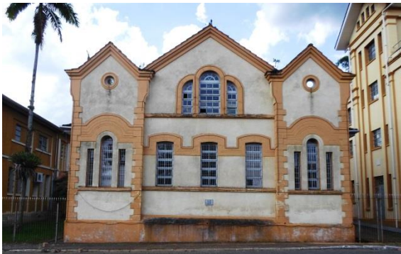
Figura 273 – Antigo refeitório dos Padres Salesianos. Colégio Salesiano São Paulo, Ascurra. Projeto de 1943
