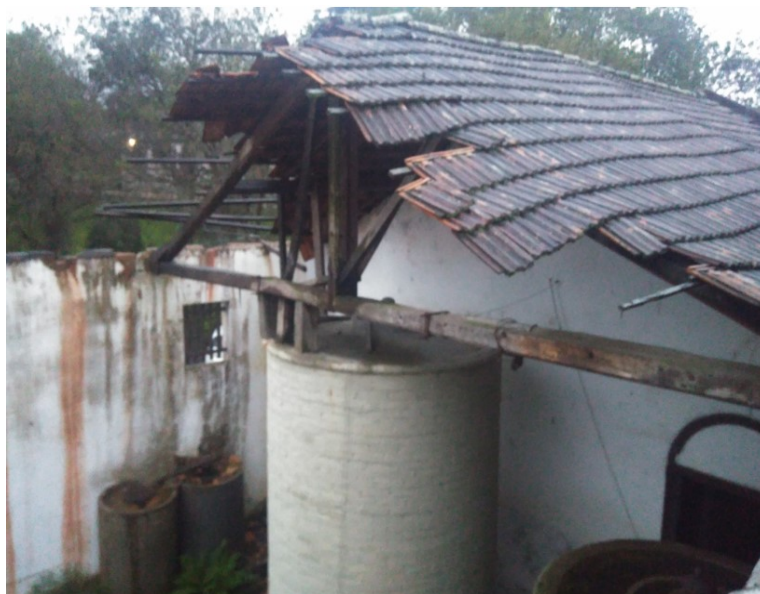
Figura 32 – Ruínas da antiga Vinícola Cadorin com teto parcial (vista interna)
