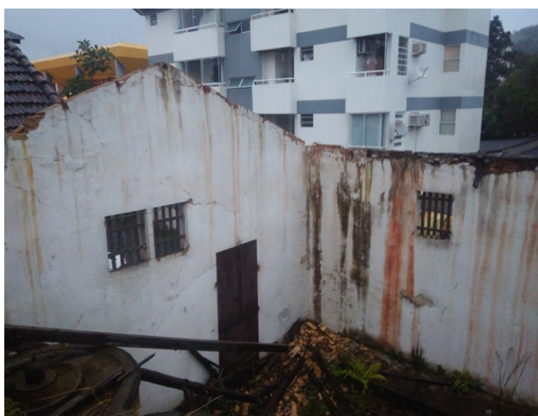
Figura 33 – Ruínas da antiga Vinícola Cadorin sem teto (vista interna)
