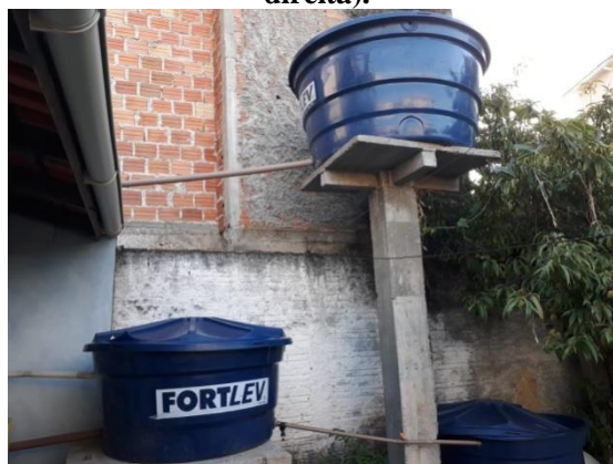
Figura 19 - Reservatório superior de água pluvial (centro) e reservatórios de armazenamento de água cinza (à esquerda e à direita).
