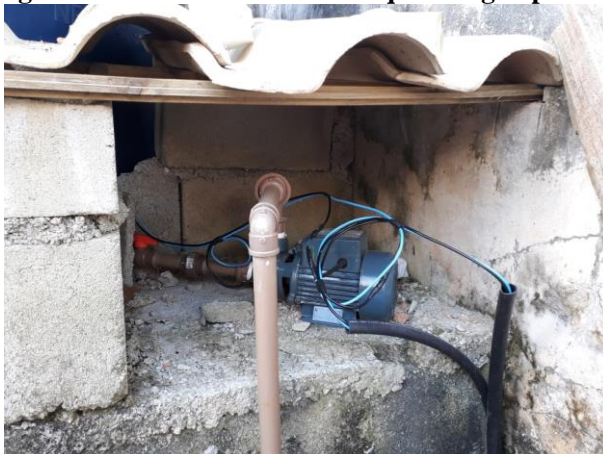
Figura 18 - Motobomba de recalque da água pluvial.
