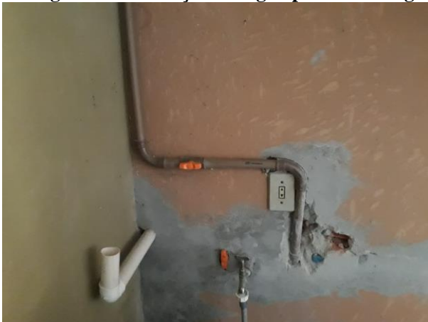
Figura 21 - Registros e tubulações de água pluvial e de água potável.
