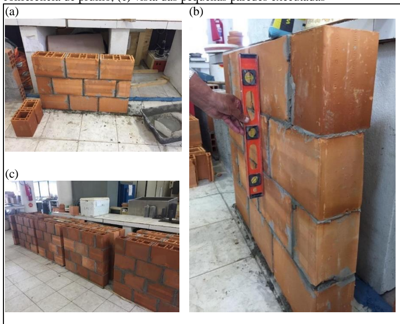
Figura 6 – Placas cerâmicas (etapa 1A): (a) execução da pequena parede, (b) conferência de prumo, (c) vista das pequenas paredes executadas
