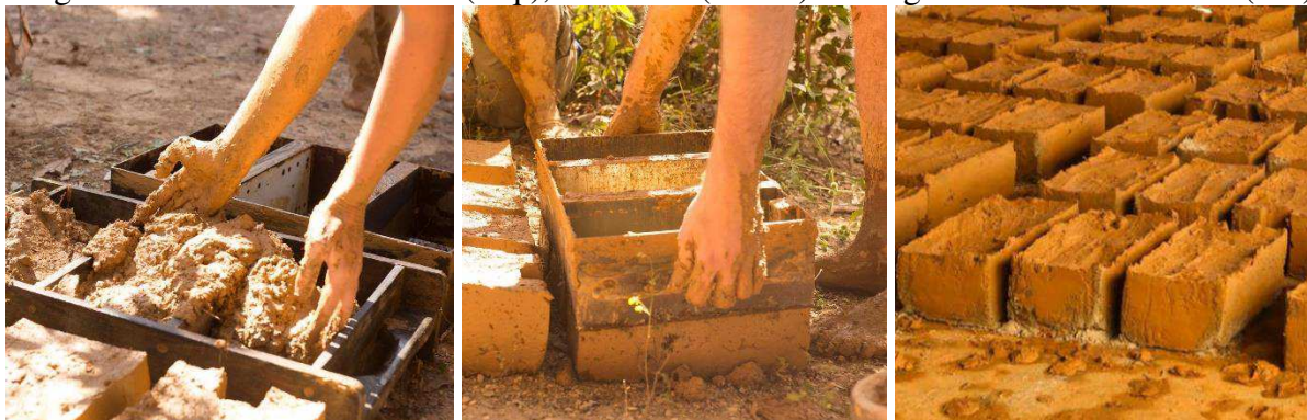
Figura 11 – Processo de forma (esq.), desforma (centro) e secagem natural dos adobes (dir.)
