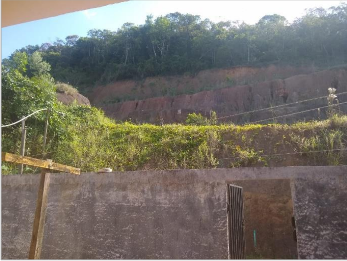
Figura 14 – Vista da parte de trás de uma das residências analisadas em Paranaguá, PR. Destaque para os cortes da obra de contenção da encosta.
