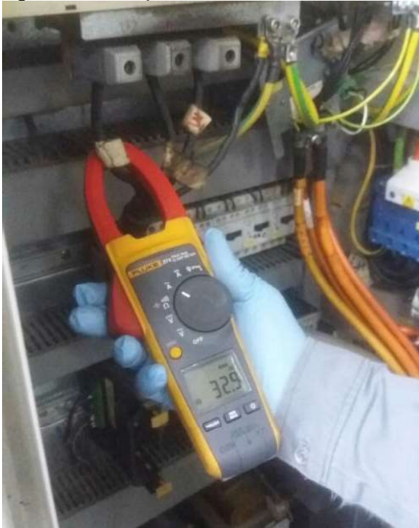
Figura 4.9 - Medição da corrente nos cabos de alimentação do servomotor do acionamento do rebolo.
