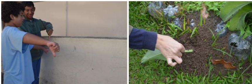
Figura 37 - Pichação na parede e Formigueiro
